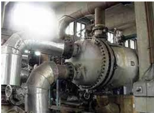
Slika br.4- Oprema u gasnoj stanici
